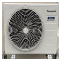
図 13 エアコン室外機
